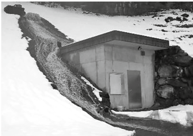
Wasseraustritt/Abfluss auf die Klausenpassstrass.
