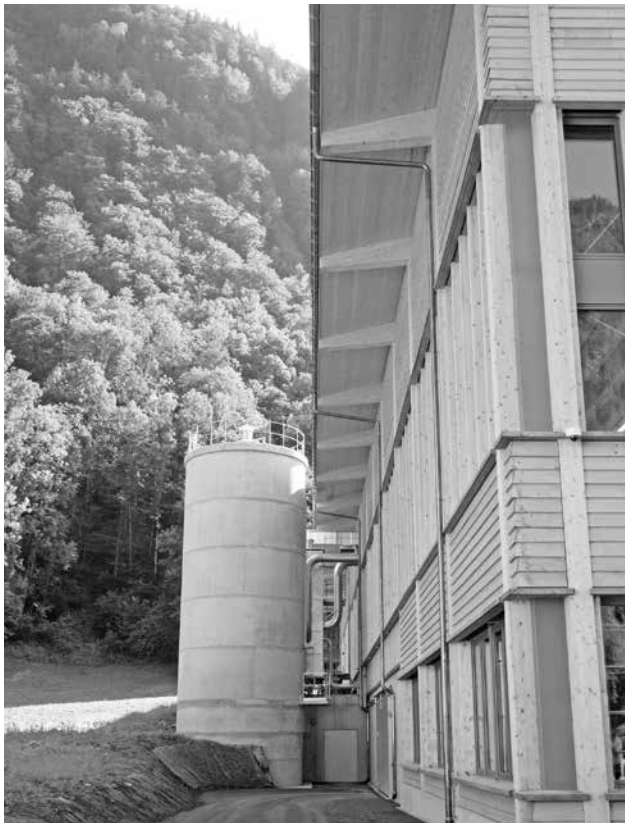
Holzspänesilo für die Heizung.
